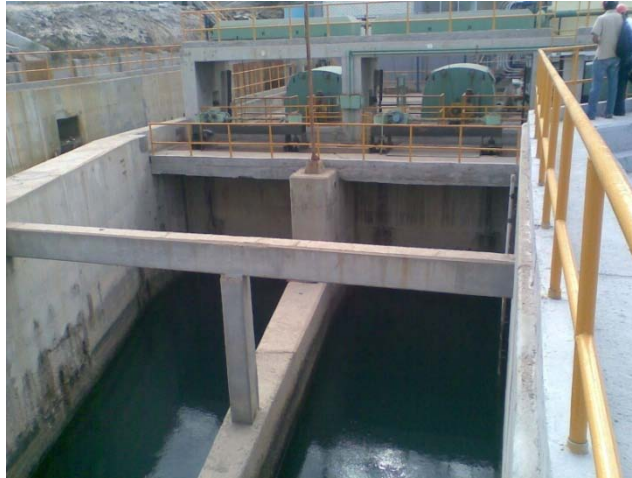
Figura 6: Canal de llamada en planta termoeléctrica
