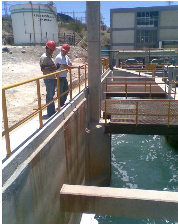
Figura 4: Medición de temperatura y salinidad en la obra de descarga de planta termoeléctrica
