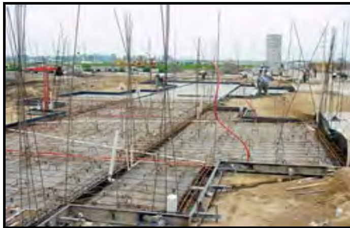
FIGURA 30. Instalaciones Sanitaria y Eléctrica.
