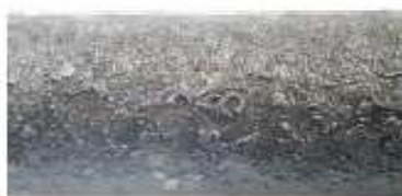
Figura 4.18 Corrosión por ácido [20] .
