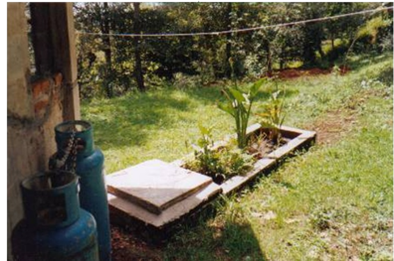
Filtro de aguas jabonosas
