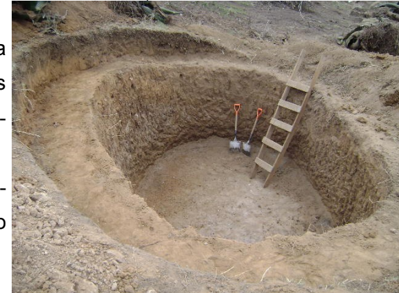
Cisterna Casita de paja, Marqueza-México.
