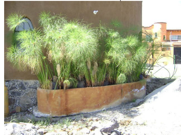
Filtro aguas jabonosas, Arq. César Añorve
