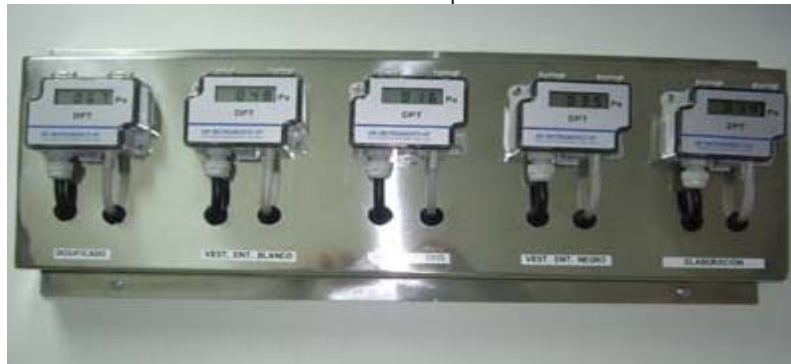
Figura 10. Tablero de manómetros diferenciales para el control de presión en áreas asépticas
