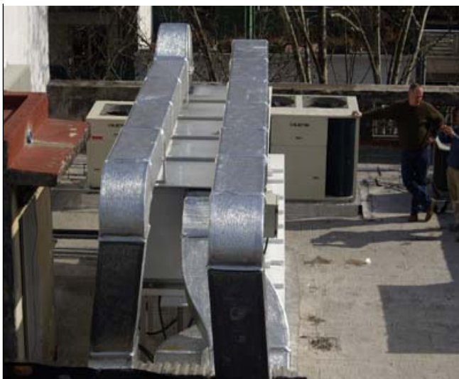
Figura 5. Ductos de aire acondicionado
