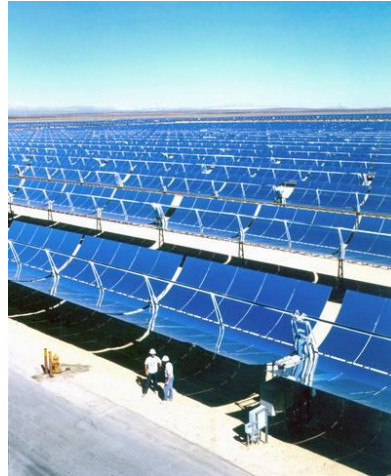
Figura 1.6. Imagen de un sistema de concentración solar tipo canal parabólico.
