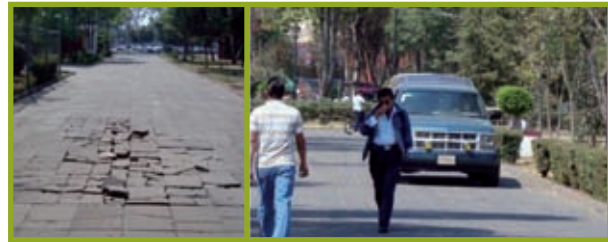
Fig. 14. El tránsito vehicular ha desgastado algunas zonas de pavimento lo que pudiera ocasionar accidentes a usuarios peatones y ciclistas.
