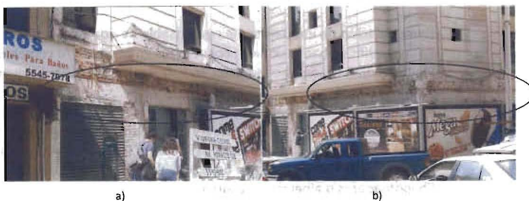
Figura IV.2.1 Vista de la ranura horizontal en muro en planta baja
