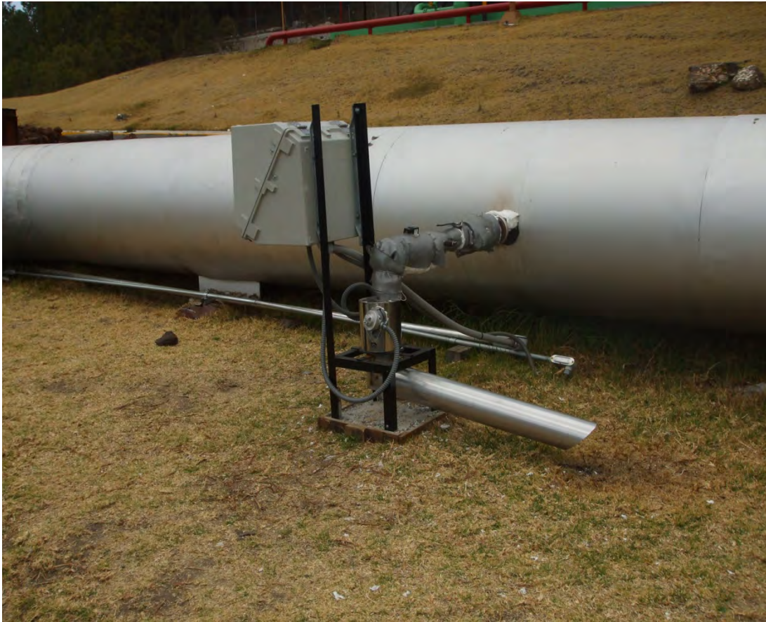
Figura 4.11 Calorímetro instalado en sitio
