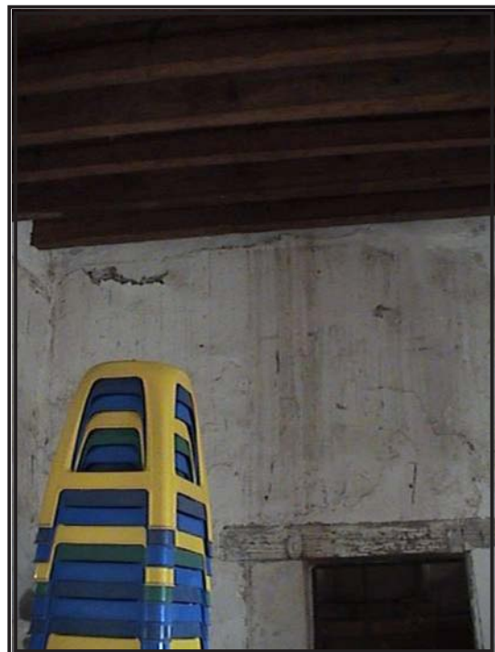
Figura 25: Nótese como la humedad se ha infiltrado desde arriba dañando a los muros de adobe.
