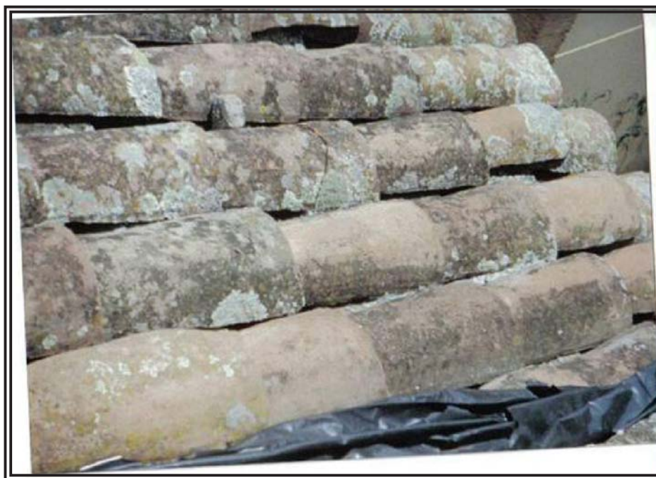
Figura 31: Cubierta invadida por vegetación parásita
