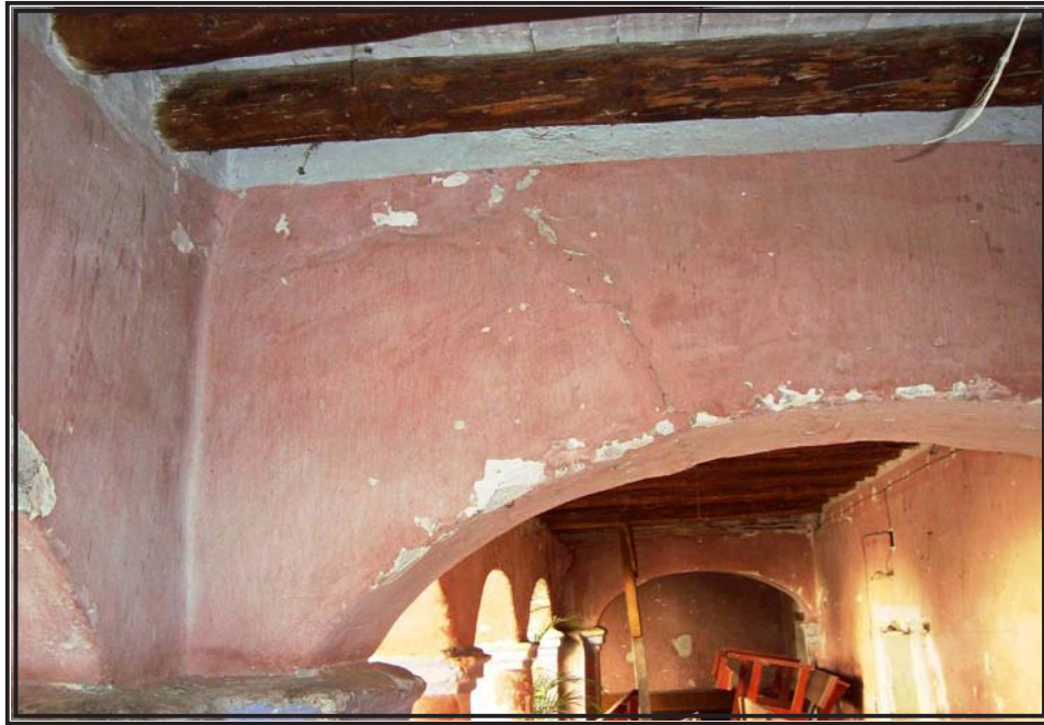
Figura 36: Grieta en arco de la esquina sur oriente del claustro. Al fondo apuntalamiento por vigas podridas.
