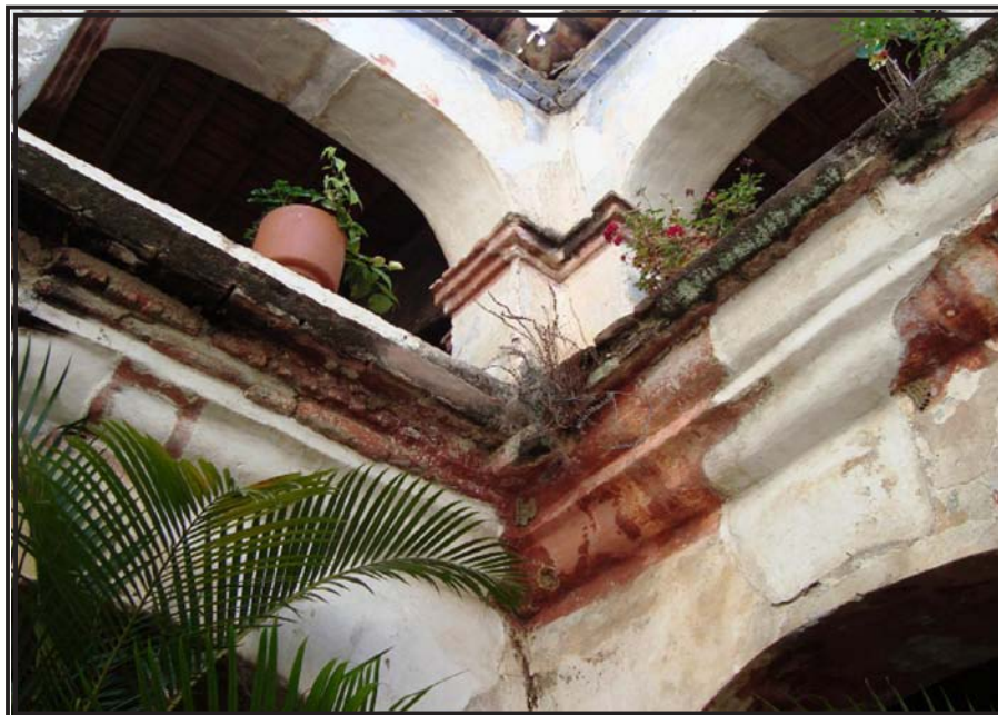
Figura 30: Vegetación parásita en las cornisas
