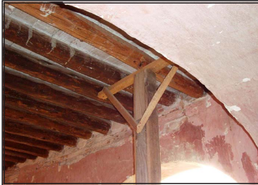
Figura 29: Apuntalamiento por vigas podridas
