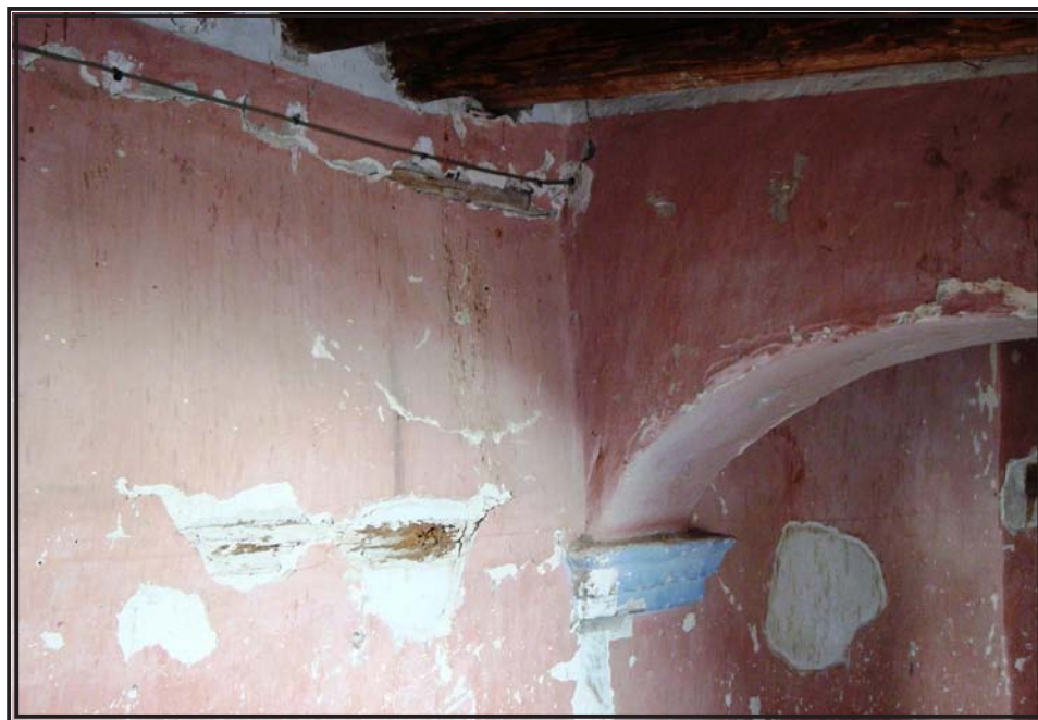
Figura 37: Grieta al centro de arco en la esquina sur oriente del claustro.
