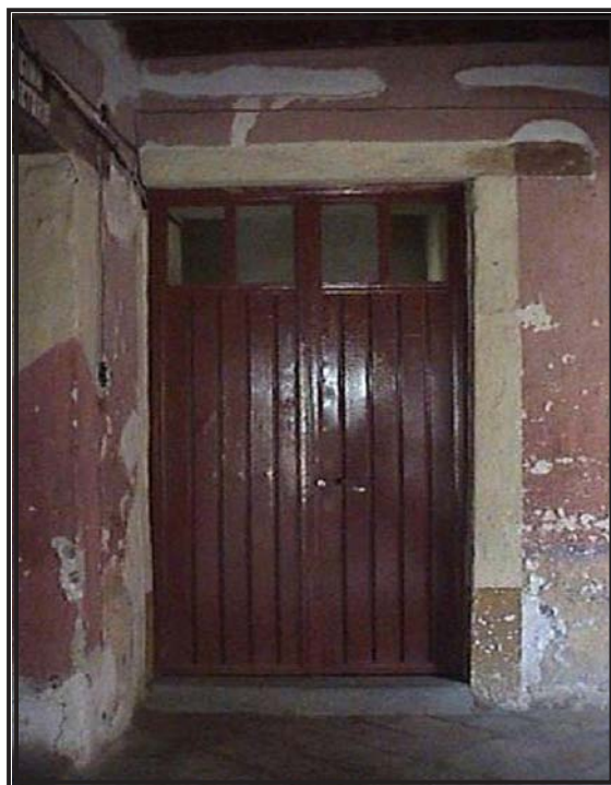
Figura 22: La puerta que comunica la portería con el interior de I claustro ha sido remplazada por una de lámina y el piso de la habitación cubierto con una losa de concreto.
