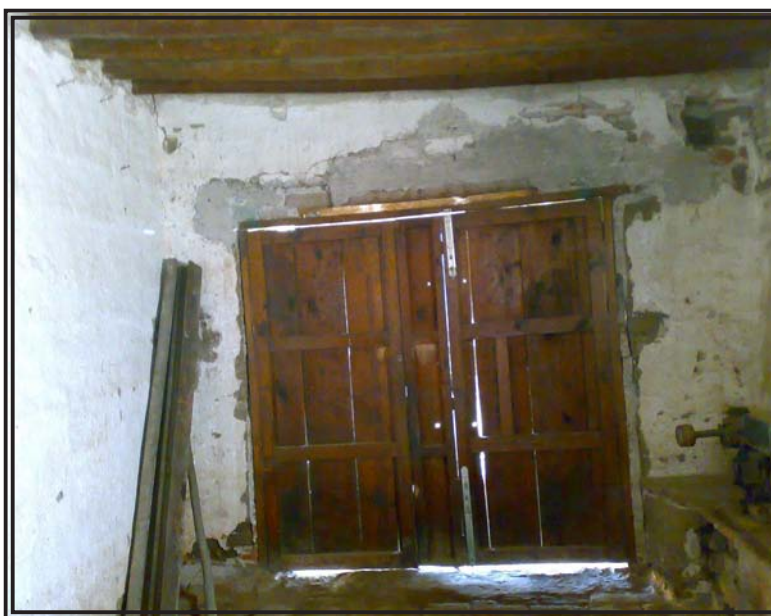
Figuras 26 y 27: La antigua sala de Profundis ahora utilizada como cochera ha ido perdiendo el recubrimiento de los muros debido a la humedad mientras que el adobe de los muros al quedar expuesto empieza a deslavarse.
