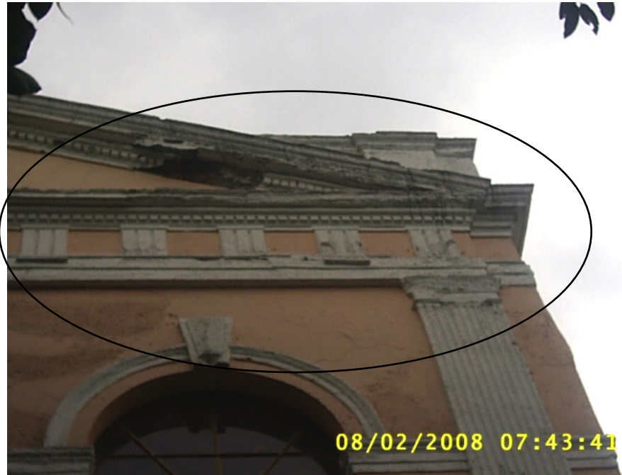
F- 43 El frontón izquierdo se encuentra dañado
