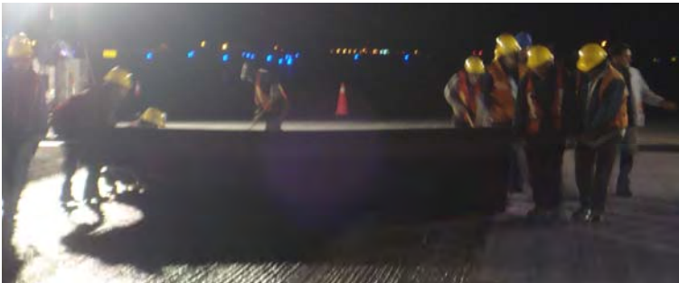
FIG. RA.3 COLOCADO DE GEOTEXTIL A MANO POR 4 OBREROS EN LA PISTA 05R-23L DEL AEROPUERTO INTERNACIONAL DE LA CIUDAD DE MÉXICO, OCTUBRE 2008
