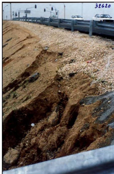
FIG. 3.31 TERRAPLÉN CARRETERO DESPUÉS DE LLUVIA. MARCAS DE EROSIÓN FORMADAS POR EL ESCURRIMIENTO DE AGUA SOBRE EL TALUD
