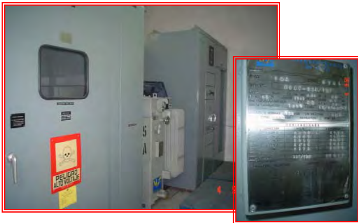
Subestación del CELE
