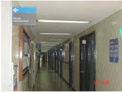
Sistema de iluminación
