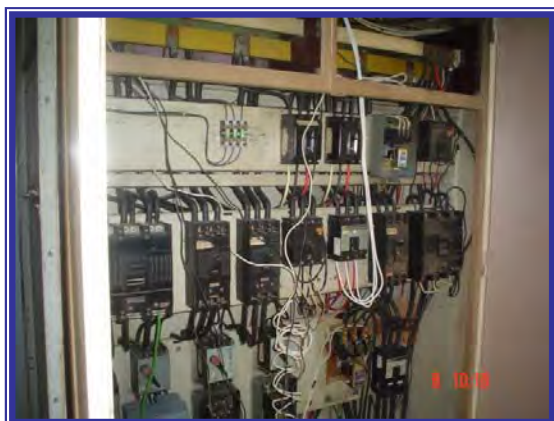
Subestación del CCH
