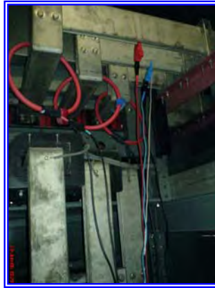
Conexión de equipo de medición
