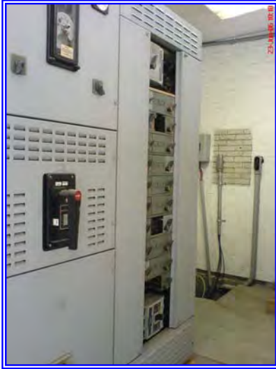
Subestación del Instituto
