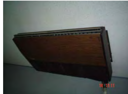
Sistema de acondicionamiento ambiental
