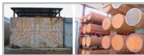
Figura 4.11- Cuarto de los cilindros de almacenamiento de hidrógeno con una ventilación adecuada (Tanaka y col., 2007)
