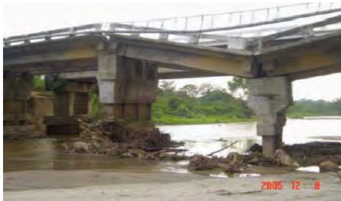
Figura 2.20 Daño en la superestructura del puente Tepuzapa por asentamiento de uno de sus apoyos
