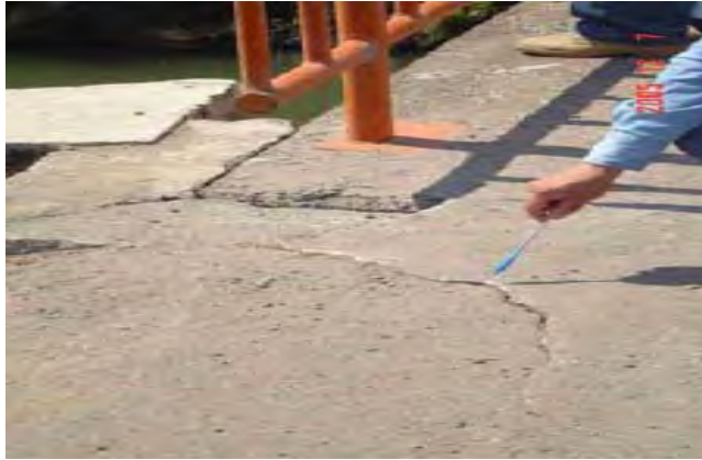
Figura 2.6 Daños estructurales en el puente Texcuyuapan
