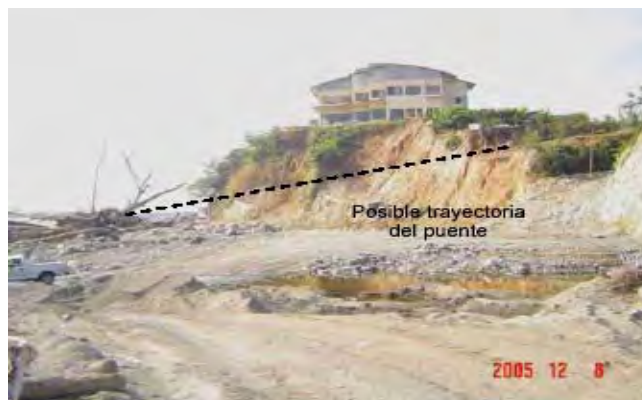
Figura 2.18 Zona erosionada por el río Coatan, lo que era el terraplén de acceso del puente de la Colonia Obrera
