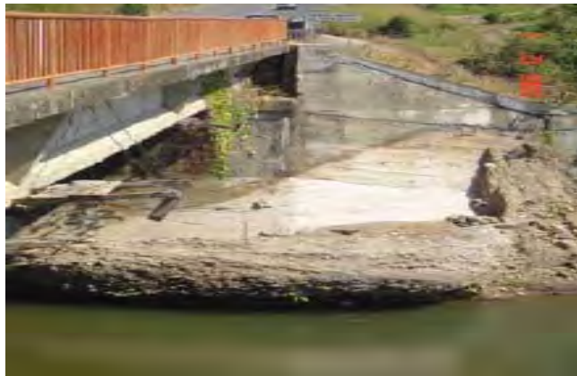
Figura 2.5 Erosión en uno de los apoyos del puente Texcuyuapan
