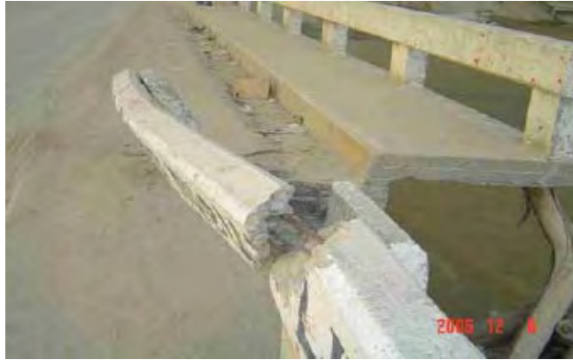
Figura 2.8 Daños en el puente Huixtla ante el paso del huracán Stan
