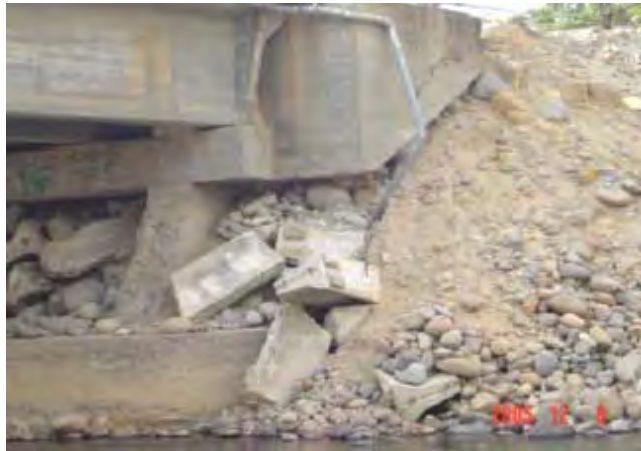
Figura 2.13 Daño en uno de los apoyos del puente Huehuetan
