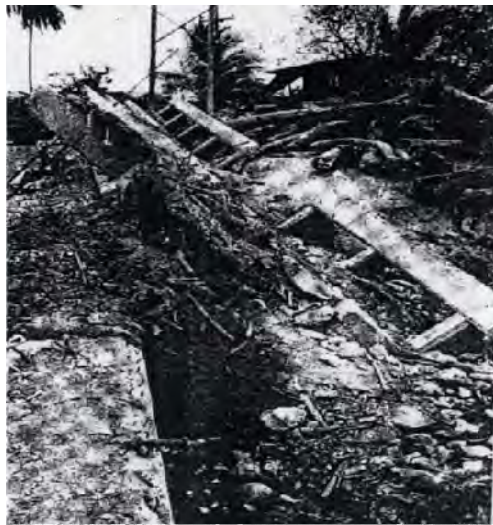
Figura 2.25 Colapso de una carretera en el Distrito Phibun puente que fue desbordado por flujo de escombros, en Febrero de 1989
