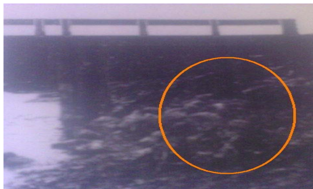
Figura 2.41 Erosión debajo del puente en la margen del río, cerca del Distrito Ban Nasan
