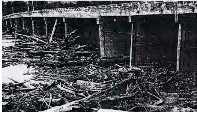
Figura 2.50 Árboles que obstruyeron el flujo de agua bajo un puente de la cordillera Khao Luang, en Diciembre de 1988
