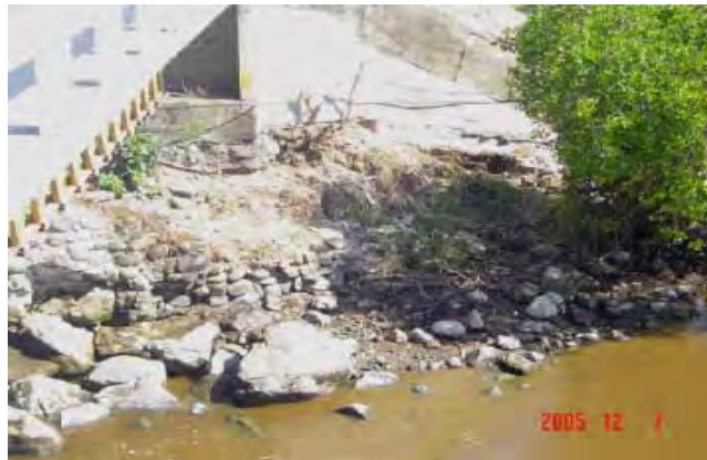
Figura 2.4 Daño parcial en las obras de protección del estribo del puente San Benito
