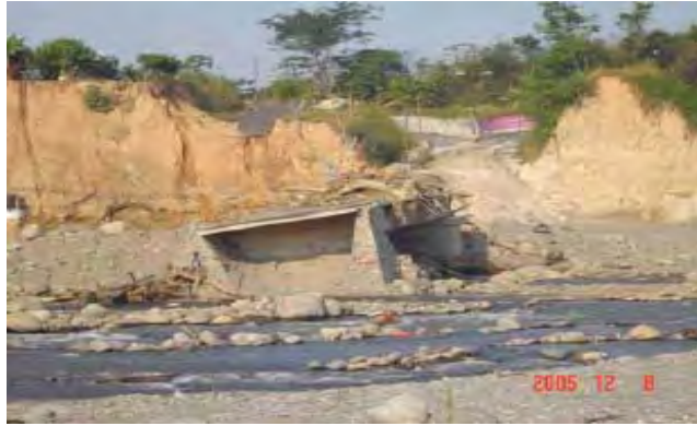
Figura 2.16 Puente de la colonia obrera, colapsado
