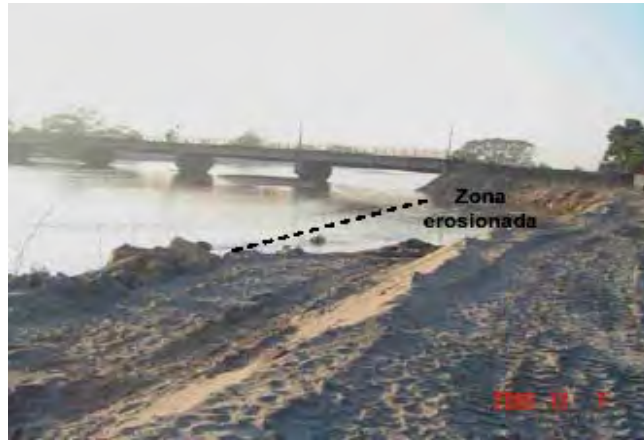
Figura 2.9 Erosión del terreno a causa de la corriente del río durante el paso del huracán Stan
