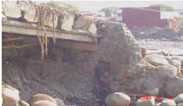
Figura 2.19 Colapso de la subestructura del puente de la Colonia Obrera
