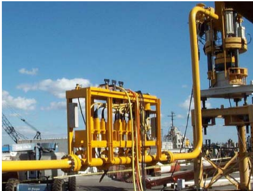
Jumper con medidor de flujo integrado.
