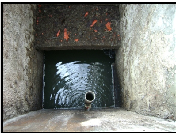
Figura-19 Cámara de agua tratada de la planta BRAIN C. vigilancia estadio Olímpico
