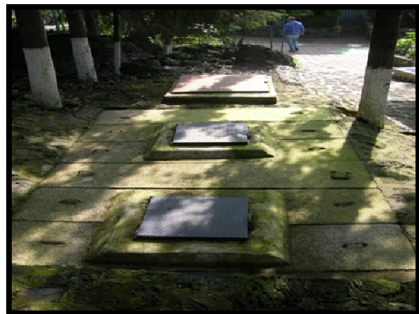
Figura-20 PTAR BRAIN ubicada en las canchas de fútbol "pumitas"
