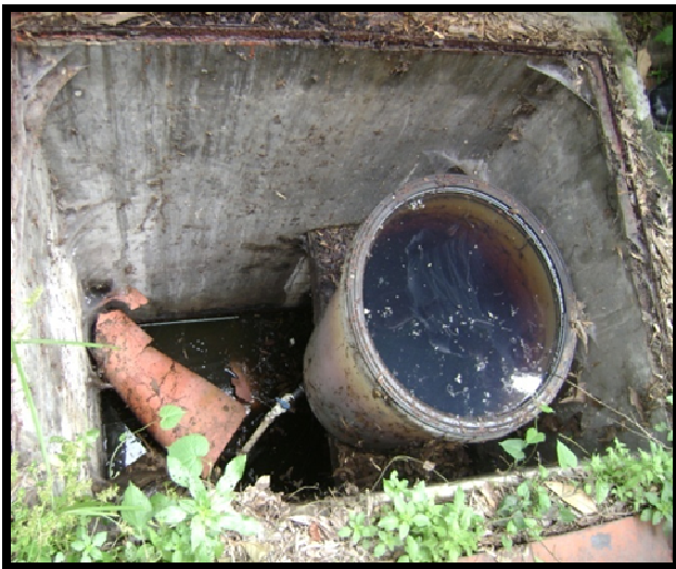
Figura-17 Falta de mantenimiento planta BRAIN Odontología ala norte
