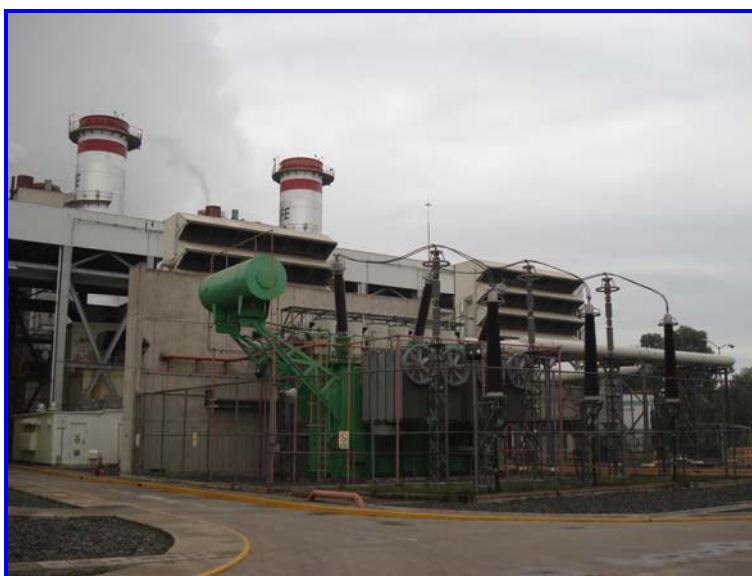
Figura 1.27 Transformador para las Unidades 6 y 7.
