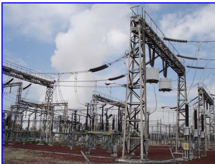
Figura 4.1 Subestación tipo exterior 230 kV.
