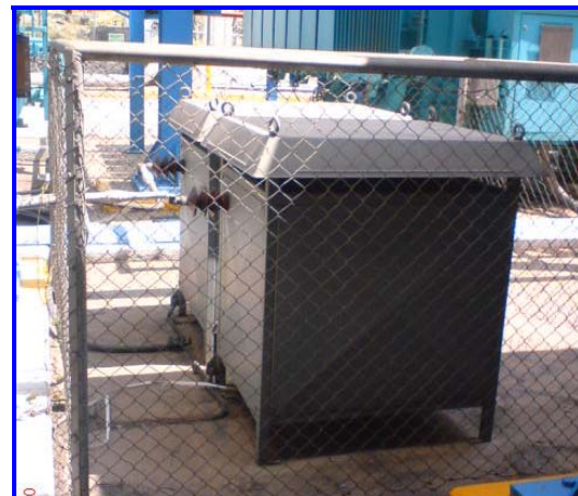
Figura 1.39 Resistencias de puesta a tierra del transformador de servicios propios de la Unidad 4.
