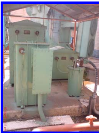
Figura 5.8 (Derecha) Puesta a tierra del neutro del transformador de servicios propios de la unidad 3
