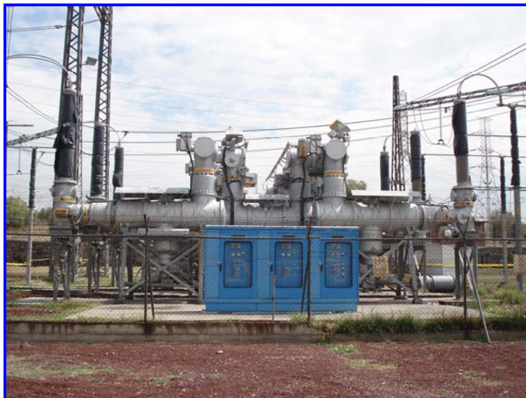
Figura 4.5 Subestación en SF6 230 kV.
