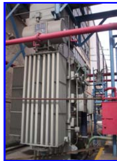
Figura 4.9 Transformador de servicios propios U-1
