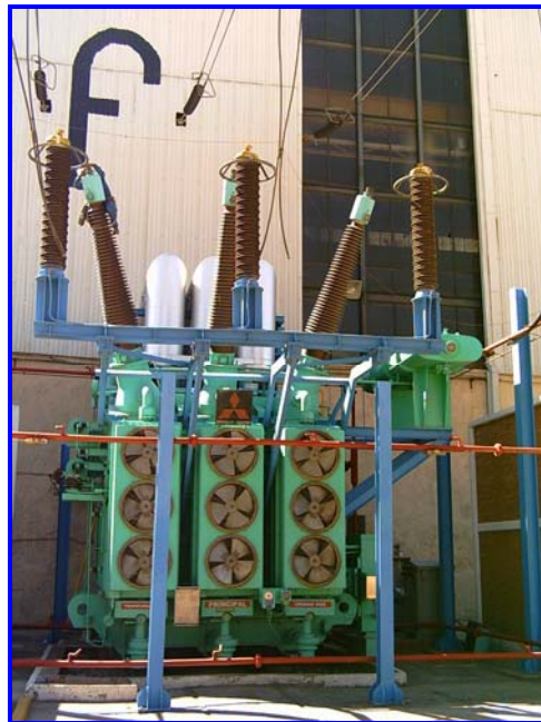
Figura 1.24 Transformador Unidades 2 y 3.
