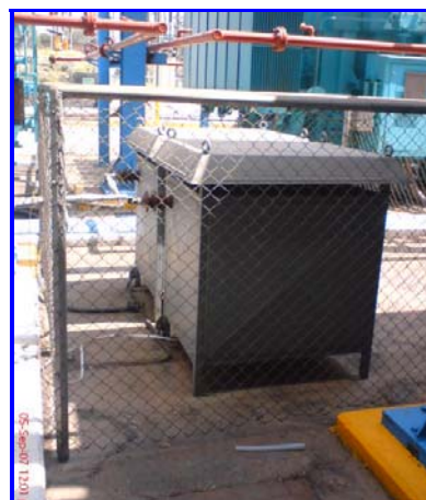
Figura 4.12 Resistencia conectada en el neutro del transformador de arranque de la U-4.
