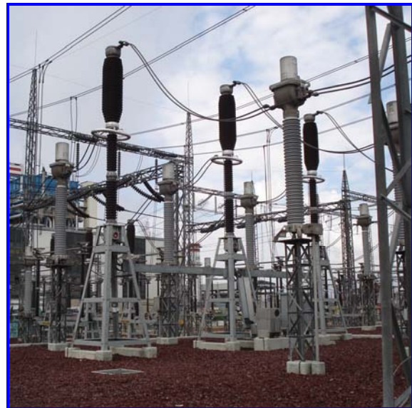
Figura 1.30 Interruptores de tanque vivo.
