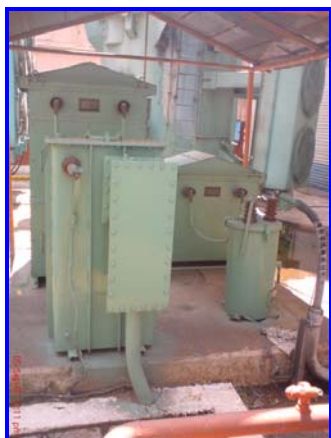
Figura 1.42 Puesta a tierra del Generador y el Transformador de servicios propios de la Unidad 2.
