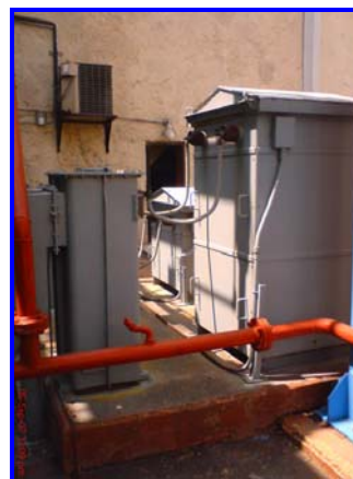
Figura 1.43 Puesta a tierra del Generador y el Transformador de servicios propios de la Unidad 3.
