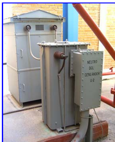
Figura 4.11 Resistencia conectada a través de un transformador en el neutro del generador 2.
