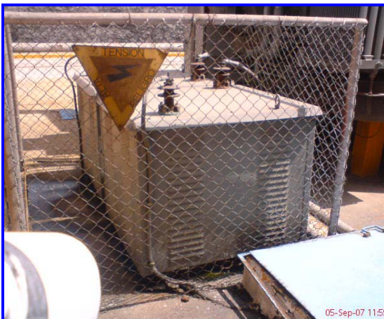
Figura 1.38 Resistencias de puesta a tierra del transformador de arranque de la Unidad 4.
