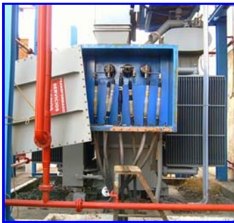
Figura 4.8 Transformador de servicios propios U2
