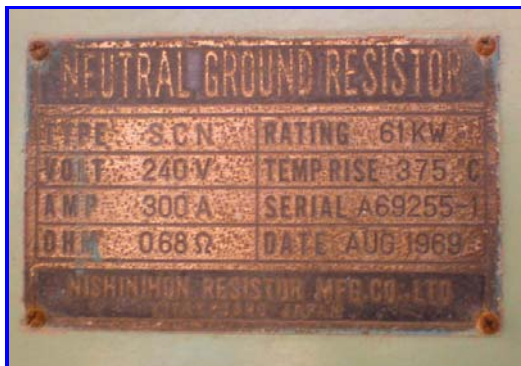
Figura 1.44 Placa de datos de la resistencia de puesta a tierra de los Generadores 2 y 3.
