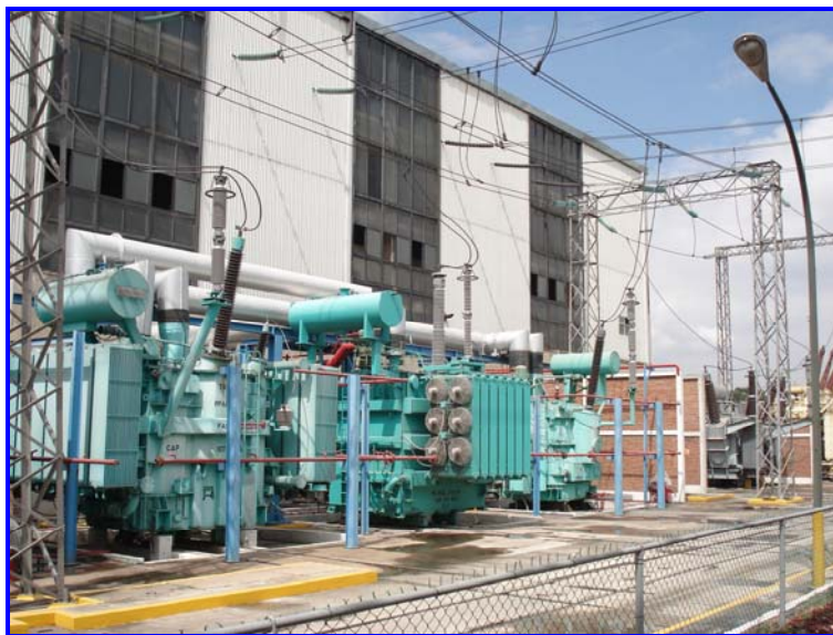
Figura 1.25 Banco de transformadores monofásicos de la Unidad 4.
