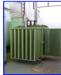
Figura 4.10 Transformador torre de enfriamiento U1
