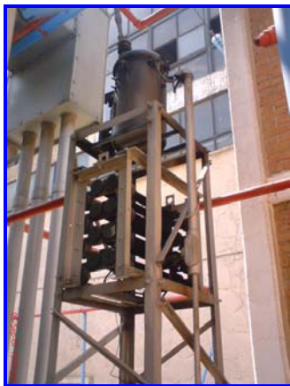
Figura 1.40 Puesta a tierra del Transformador de arranque de la Unidad 1.
