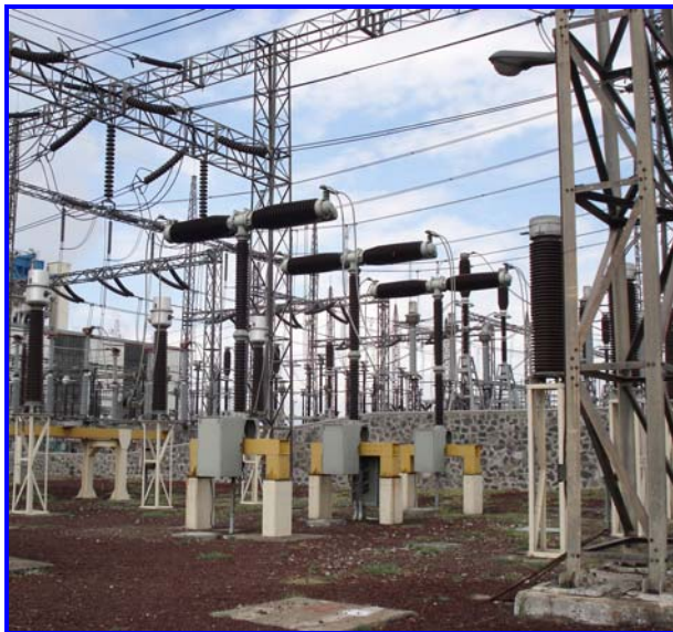
Figura 1.29 Interruptores de tanque vivo.
