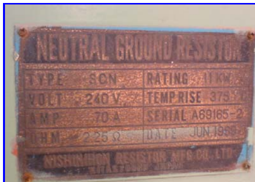
Figura 1.45 Placa de datos de la resistencia de puesta a tierra de los transformadores de servicios propios de las unidades 2 y 3.
