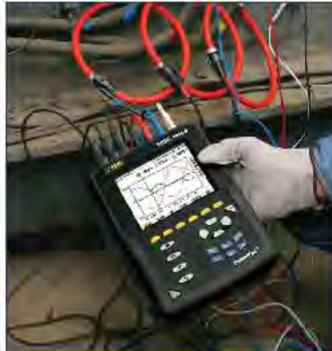
Análisis de calidad de potencia sobre un panel de tres fases utilizando las sondas de corriente flexibles AmpFlex ® .
