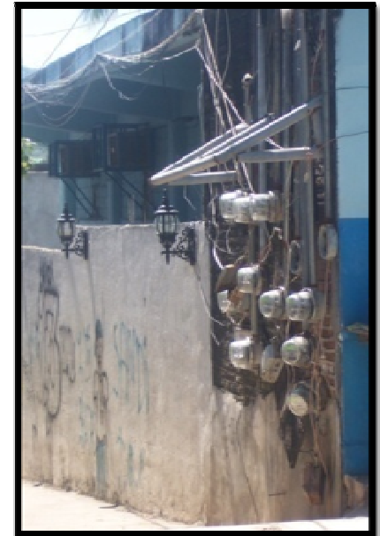
Imagen 11. Medidores mal ubicados
