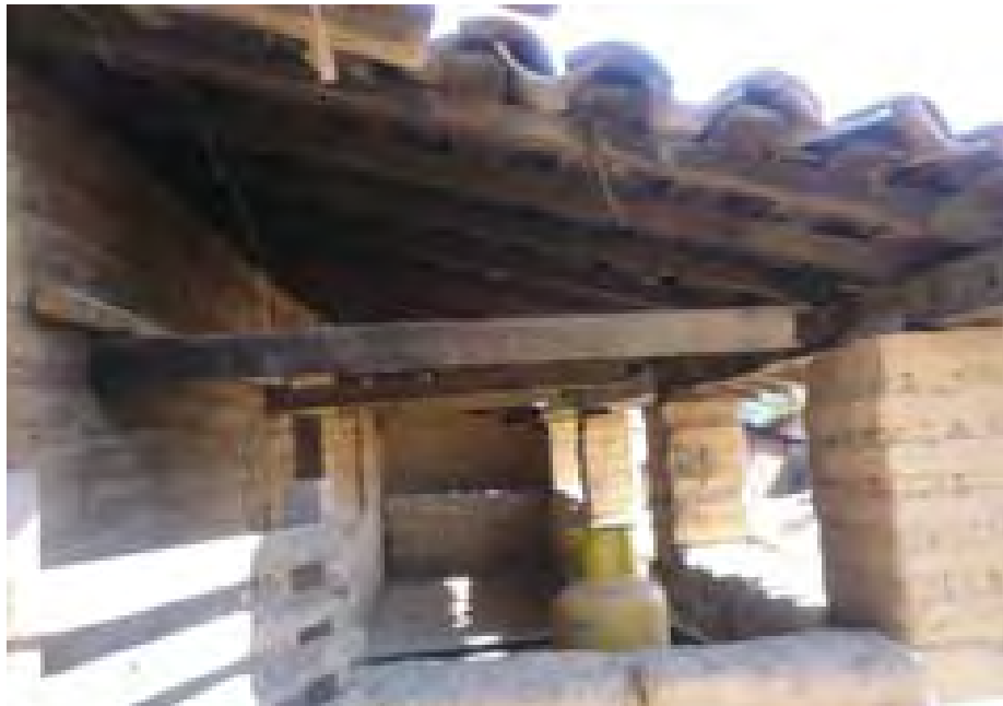
Las construcciones varían en sus alturas, en este caso la techumbre está muy baja, escasamente tiene 2.10 metros en la parte baja y 3.20 en la alta.
