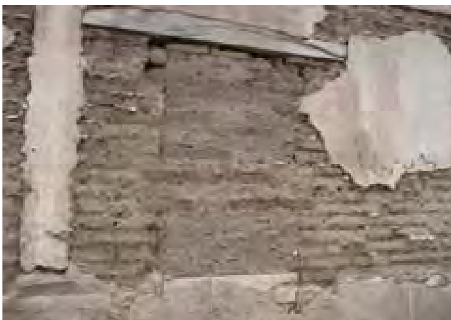
Aún se aprecian los aplanados de arena-cemento y pintados con cal viva.
