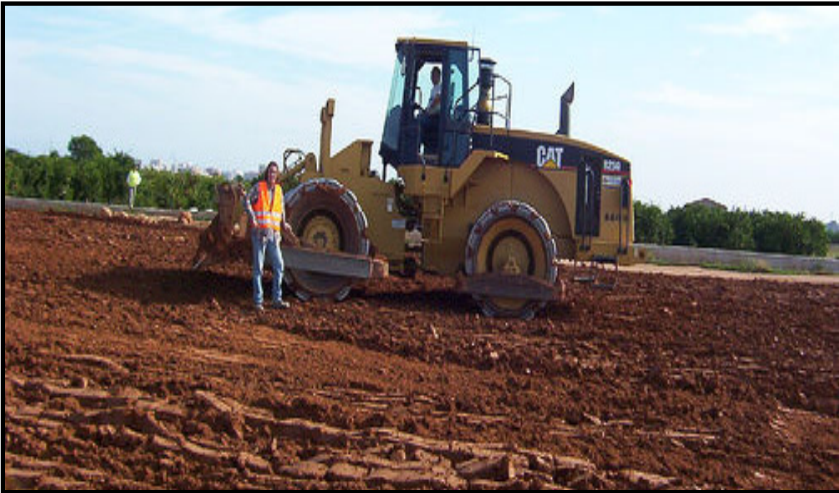
FOTOGRAFÍA III.1 “DISGREGADO DE MATERIALES”
