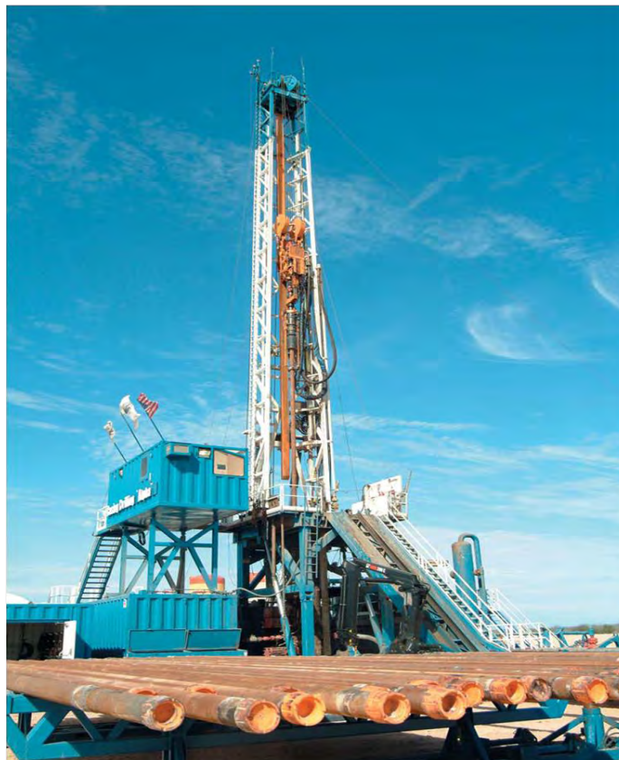
Figura 4. 17 Entubación durante la perforación y perforación direccional con tubería de revestimiento (Strickler, 2006).
