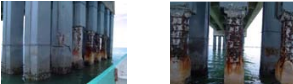
Figura 1 Muestra el daño por corrosión que presenta una estructura de concreto.
