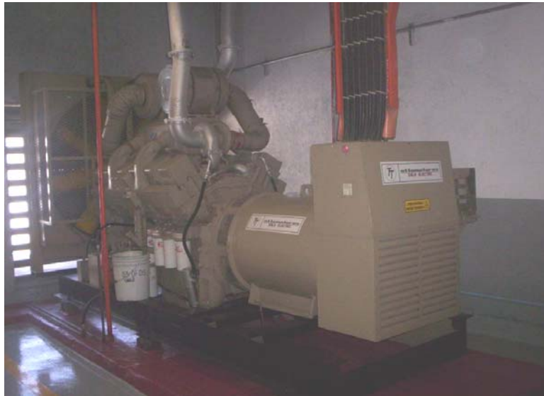
Vista panorámica maquinaria en cuarto de maquinas.
