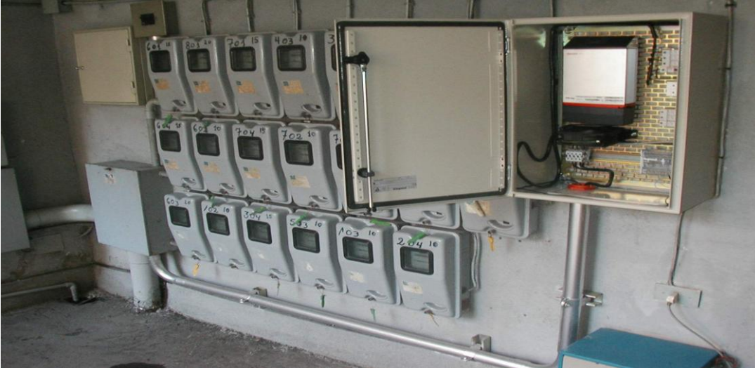
Fig. N° 16, Repetidor marca Ascom en medidores de un edificio.
