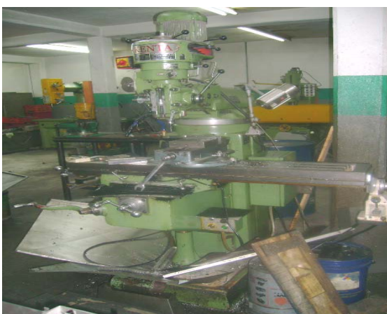
Figura 2.21. Torno horizontal a 220 V con área de trabajo reducido y centro de carga saturado.
