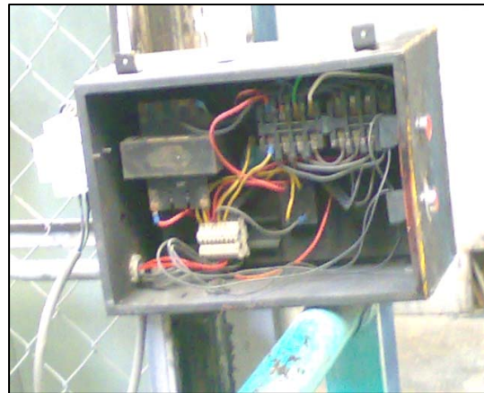
Figura 2.7 B. Cables expuestos.
