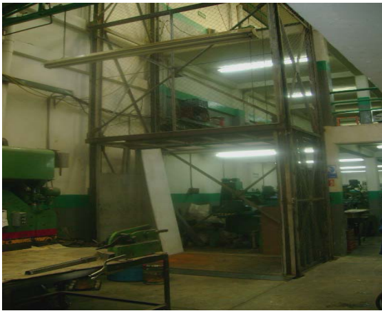
Figura 2.39. Elevador de carga. Caja de seguridad.
