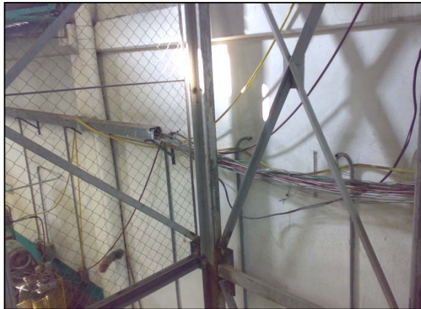
Figura 2.4. Cables expuestos cerca del elevador de carga.
