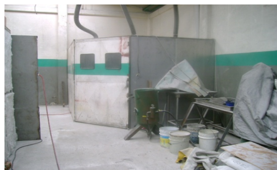
Figura 2.36. Cabina de acabado.
