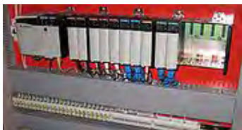
Figura 5.2 PLC moderno instalado (2008) dentro del tablero eléctrico
