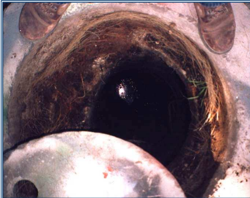
Materia vegetal que impedía destapar el pozo de visita 12
