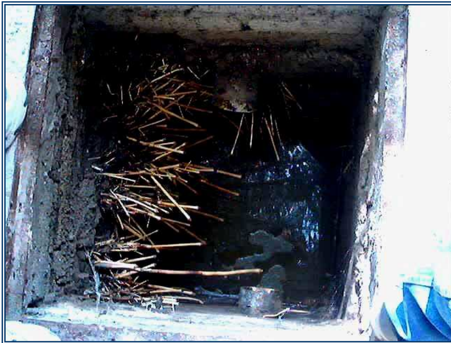
Registro R9, donde en su vecindad se encuentra una palmera, cuyas raíces se encuentran ya dentro del registro.
