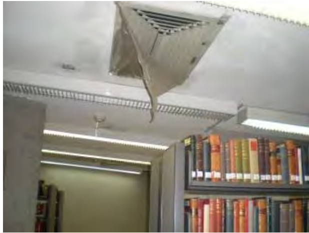
Fig. 4.3 Ventila del aire acondicionado
