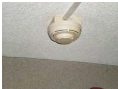
Fig. 4.4 Equipos de detección de humo
