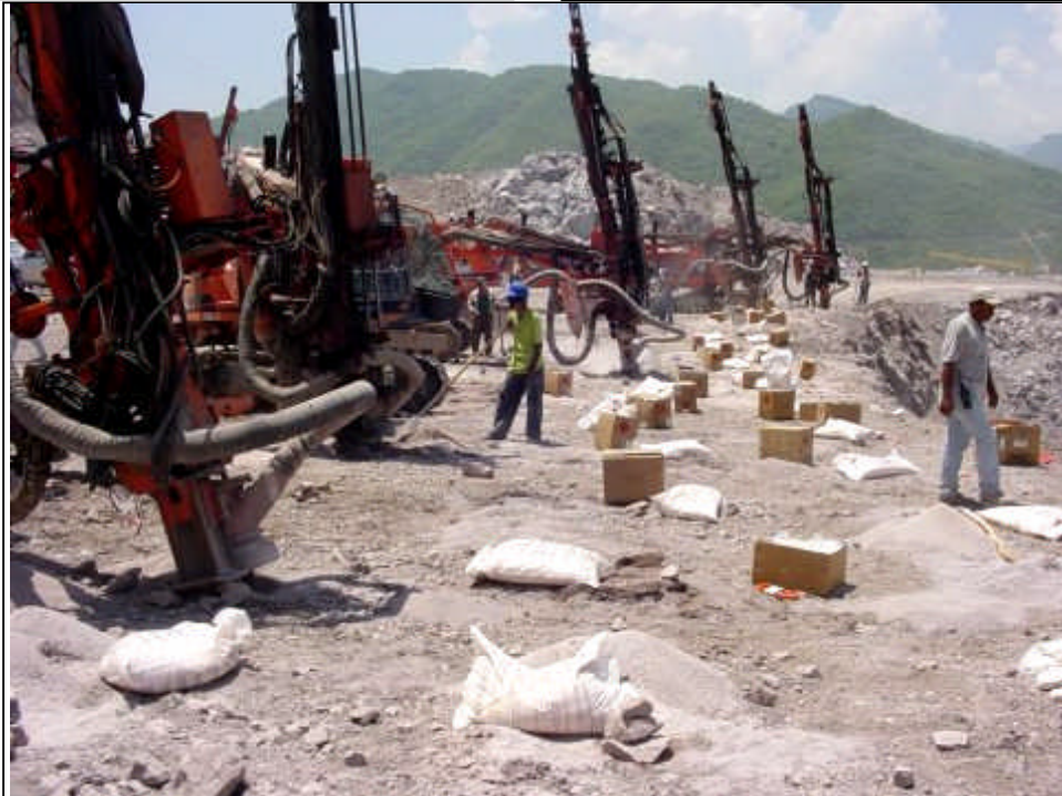
Foto 5. Preparación de voladura típica de banqueo, los barrenos cerca de la cara libre están listos para ser cargados, mientras que la maquinaria esta haciendo los barrenos restantes.
