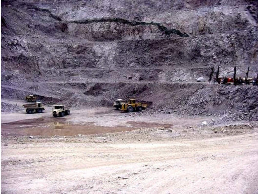
Foto 6. Vista de trabajo en un banqueo normal; tractor, cargador frontal y "yucles" acarreado el material extraído, en la parte derecha se muestra equipo dedicado a la perforación haciendo barrenos.
