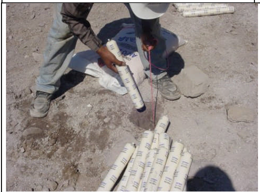
Foto 15. Deposito de las demás emulsiones (salchichas)
