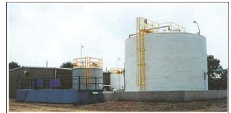
Figura 2-6.- Tanque de homogeneización.
