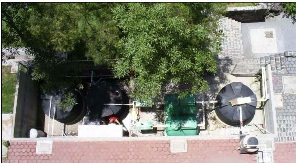
Figura B-2.- Vista aérea de la planta de tratamiento de agua residual del edificio 12 del Instituto de Ingeniería de la UNAM.
