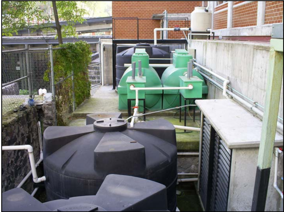
Figura B-3.- Planta de tratamiento de agua residual del edificio 12 del Instituto de Ingeniería de la UNAM
