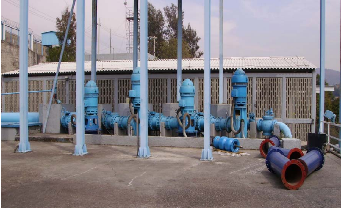
Fig. 1.2.1 Equipos de bombeo instalados en la planta potabilizadora Madín
