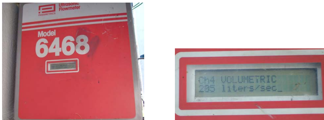
Fig. 1.2.3 Medidor volumétrico de agua
