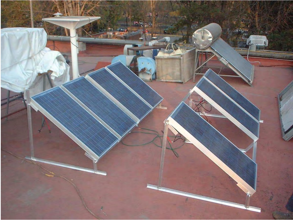
Figura 5.27 Disposición final del arreglo de los 7 módulos fotovoltaicos.
