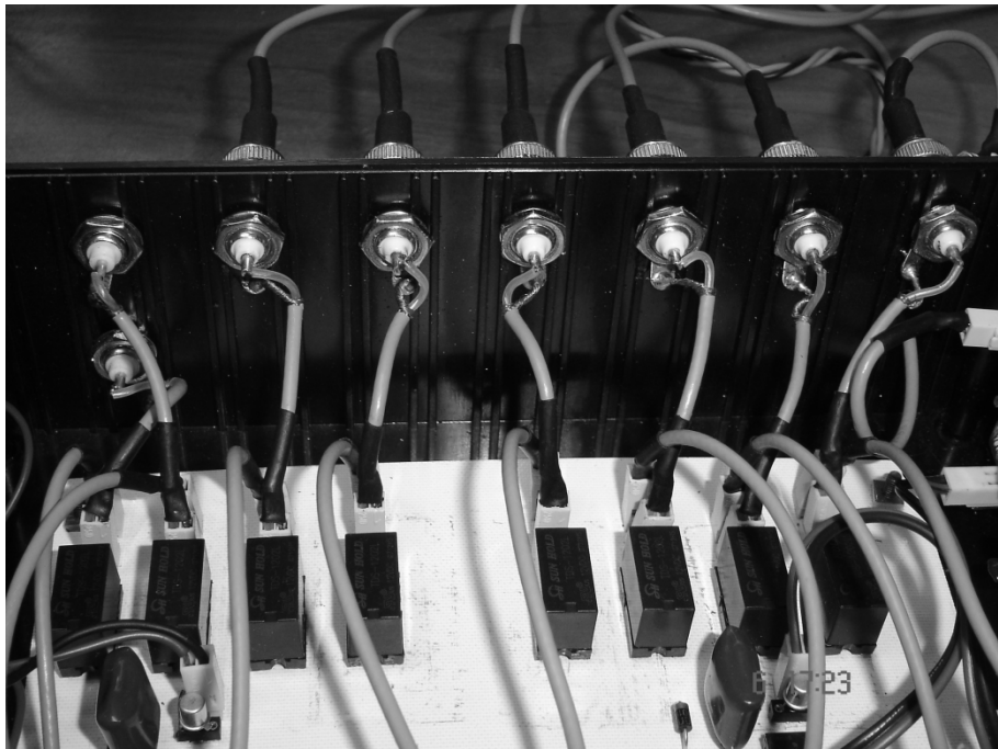
Figura 4.35. Chasis de relevadores por canal
