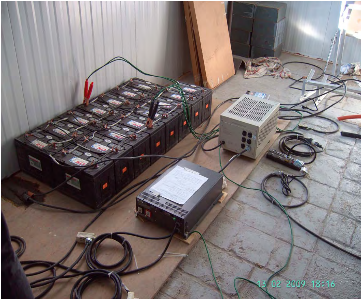
Figura 8.3 Banco de 15 baterías que forma parte del sistema de respaldo, posicionado y conectado en el sitio en que se mantendrá en operación.
