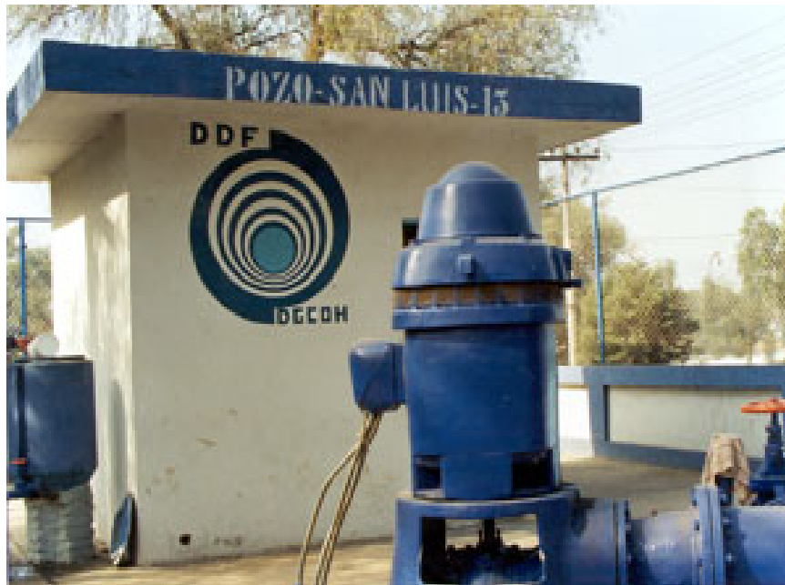
POZO DE EXTRACCIÓN DE AGUA DEL SUBSUELO.
