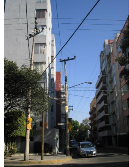
El cableado aéreo afecta la visual
