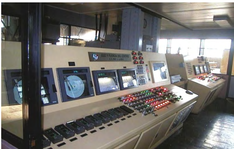
Consolas de Control Instaladas
