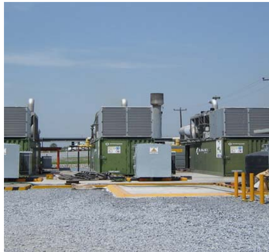
Foto 30. Planta generadora de energía eléctrica a partir de biogás.
