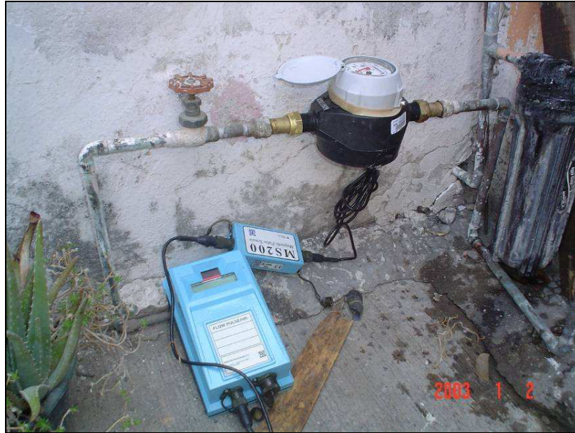
Ilustración 4.7. Instalación en campo de equipos de medición
