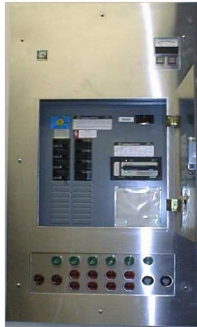
Figura 5.8.2 Tablero de aislamiento.
