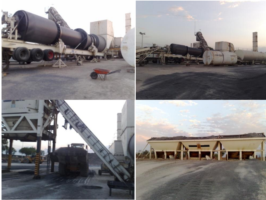
Fig. 67 Diferentes elementos que conforman la planta de asfalto.
