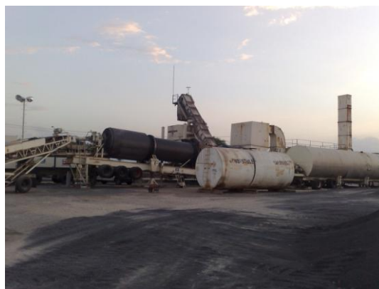
Fig. 13 Planta de asfalto.
