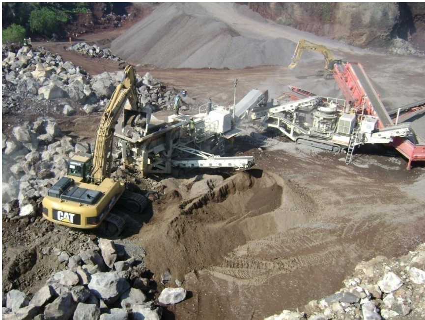
Fig. 91 Tren de procedimiento completo de planta de trituración utilizada en el proyecto.
