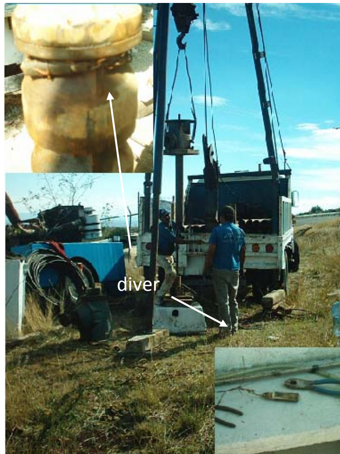
Figura 42, Instalación del sensor o 'diver' en cuerpo de tazones de bomba vertical, en el pozo Mompani II.
