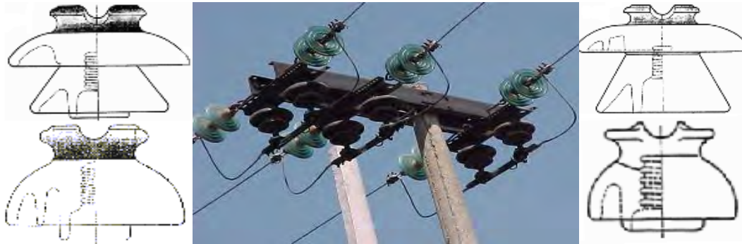
Figura 1.22. Aisladores instalados en líneas aéreas de Luz y Fuerza del Centro.
