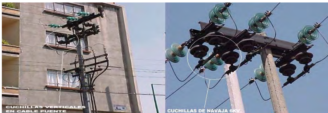
Figura 1.17. Cuchillas para seccionar utilizadas en Luz y Fuerza del Centro, 2007.
