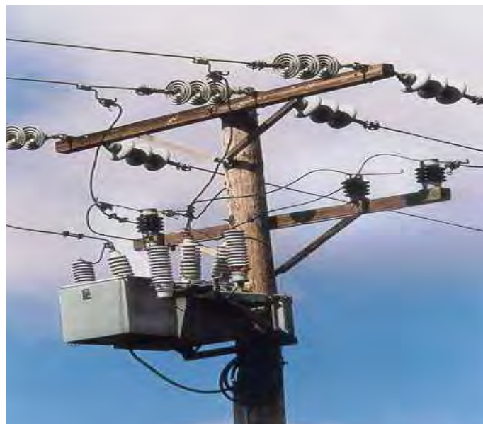
Figura 1.20. Restaurador instalado en línea aérea de 23 [kV], 2007.
