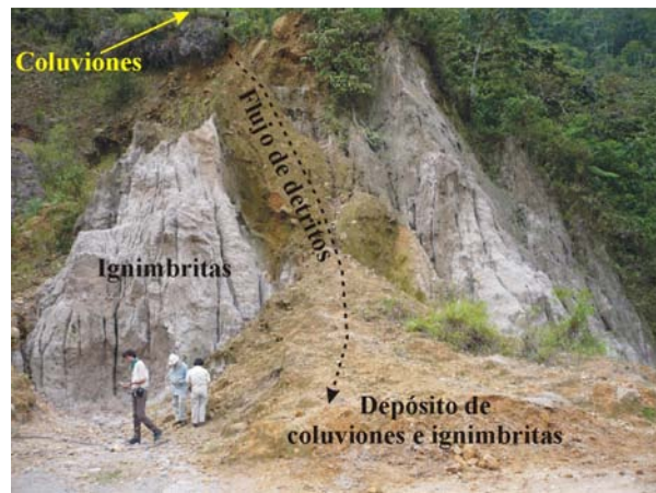
Foto IV.13. Flujo de coluviones sobre las ignimbritas en la terracería que va al poblado de Tepetzinta.
