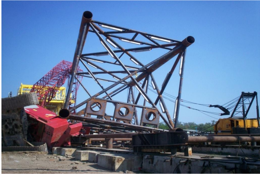
Ilustración 31. Falla de la pluma de una de las grúas y colapso de la subestructura
