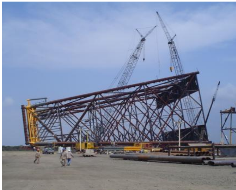
Ilustración 5. Subestructura de una plataforma en un patio de fabricación
