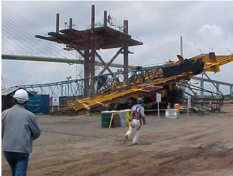
Ilustración 35. Colapso de la cubierta
