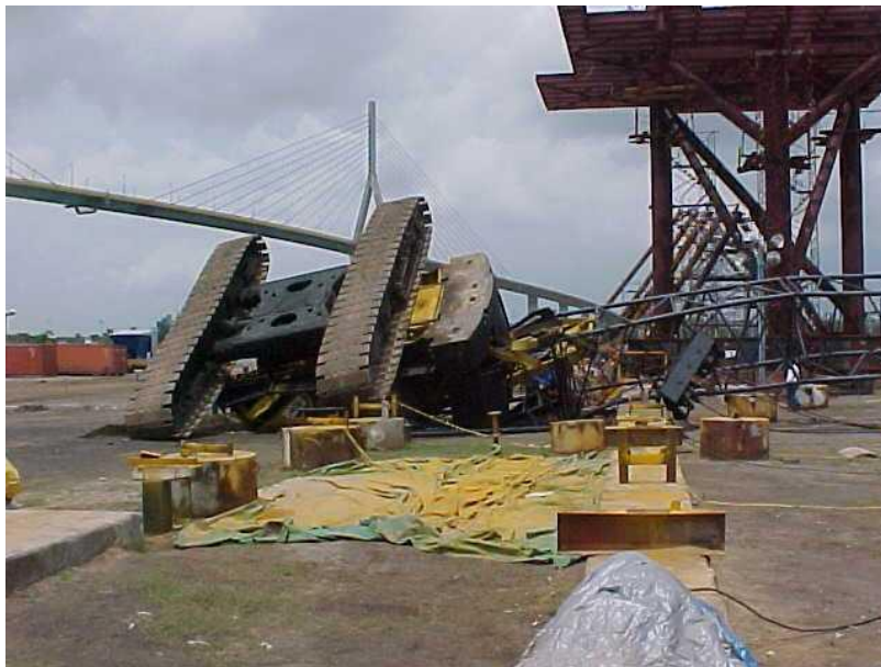
Ilustración 36. Grúa volteada después del colapso
