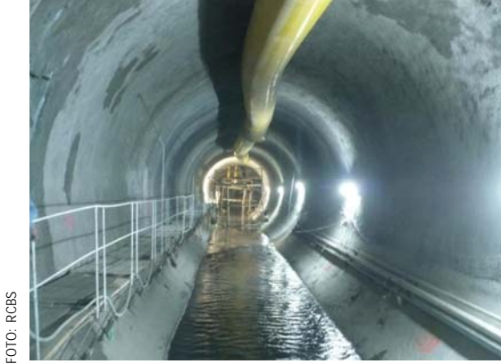
Fig. 3.26. Instalaciones en tramo lumbrera 0.
