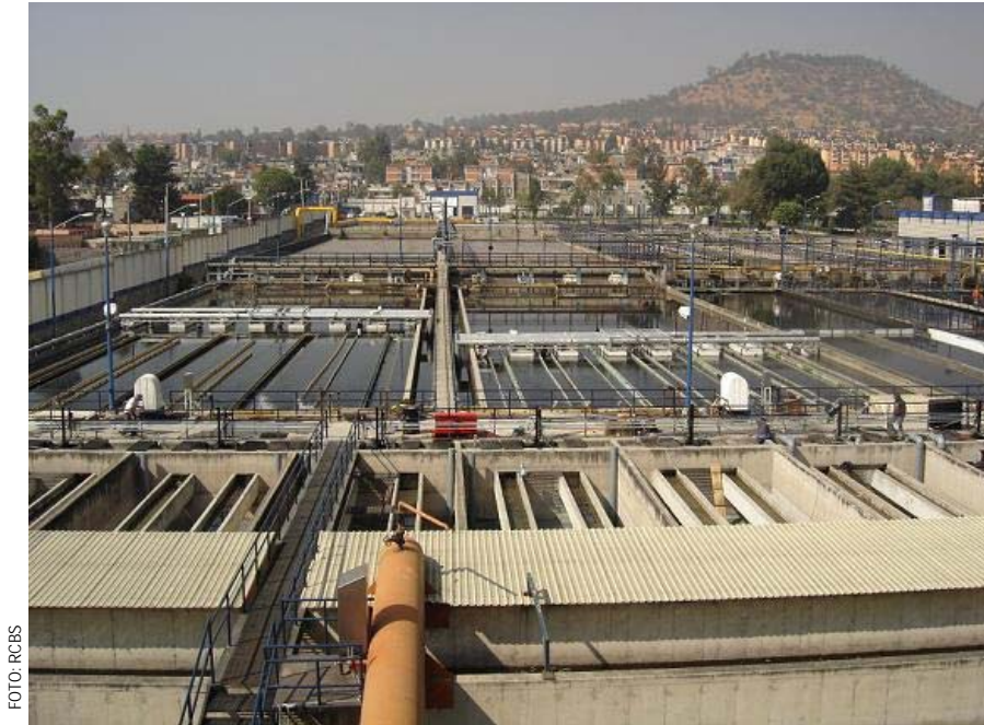
Fig. 3.1. Planta de Tratamiento de Aguas Residuales Cerro de la Estrella.
