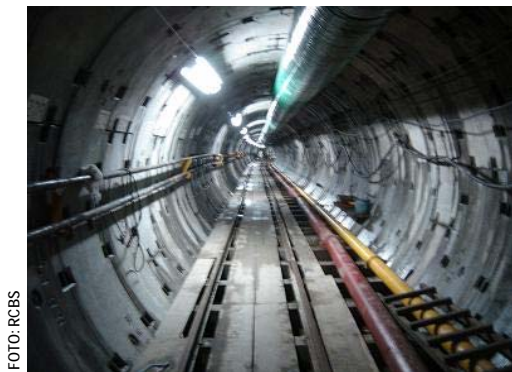
Fig. 1.12. Interceptor Oriente-Oriente, túnel con revestimiento primario a base de dovelas de concreto.
