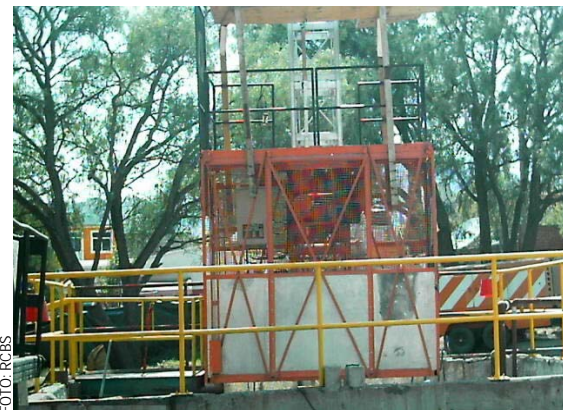
Fig. 3.13. Elevador tipo Alimak.
