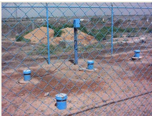
a) Estación piezométrica N° 11
