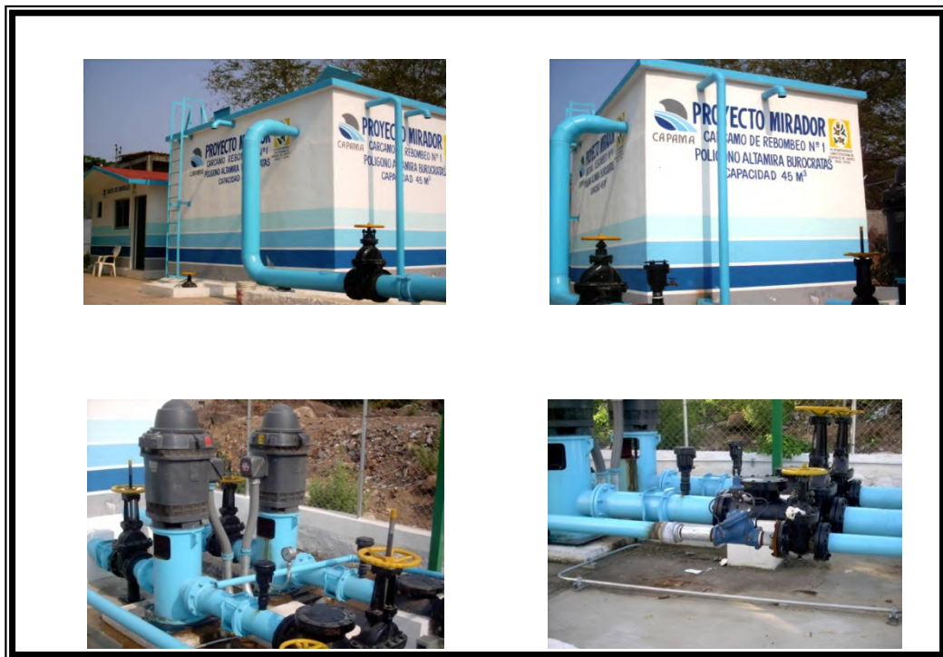
Fig. 1 Tanque Alta Mira 1
