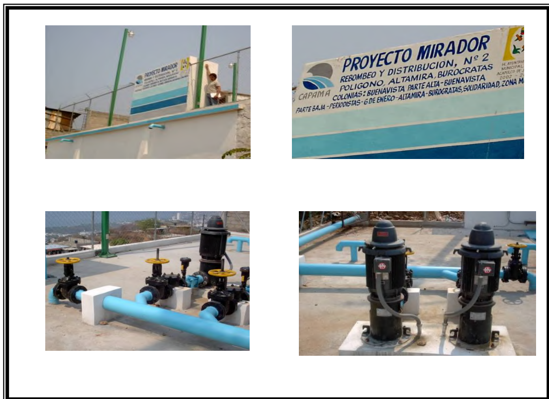
Fig. 2 Tanque Alta Mira 2
