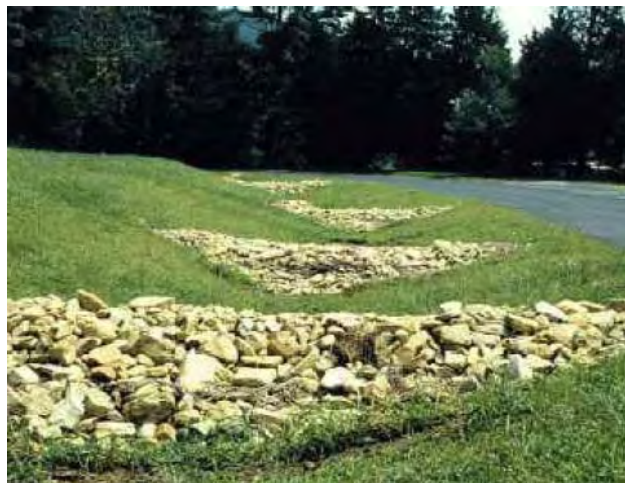
Ilustración 6. Canal de filtración con presas de piedra.
