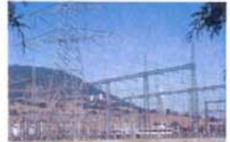
Subestación a 400 Kv, Parres D.F.
