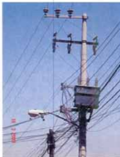
Alimentaciones comunes en transformador
